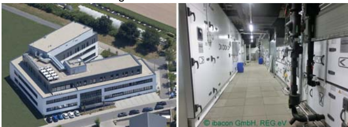
Bild: Im linken Teil der dreiflügelige Neubau der Fa. ibacon GmbH mit aufgesetzter Klimazentrale links oben und im rechten Teil eine Teilansicht der Klimazentrale innen
